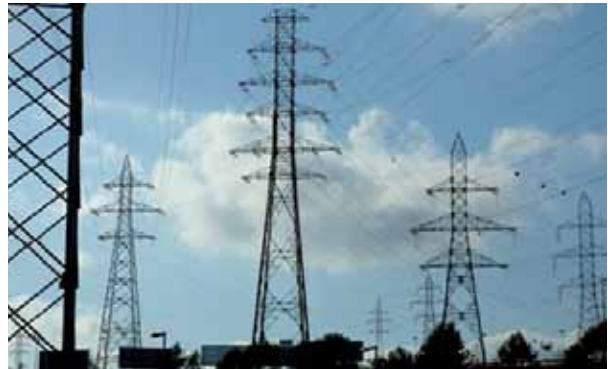
»» Línea de alta tensión de 132 kv ET Colonia Elía-ET Uruguay Sur y Estación Transformadora de 132 kv Uruguay Sur
