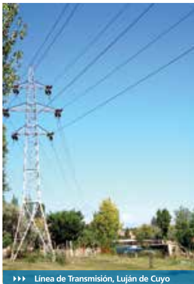
▶▶ Línea de Transmisión, Luján de Cuyo
