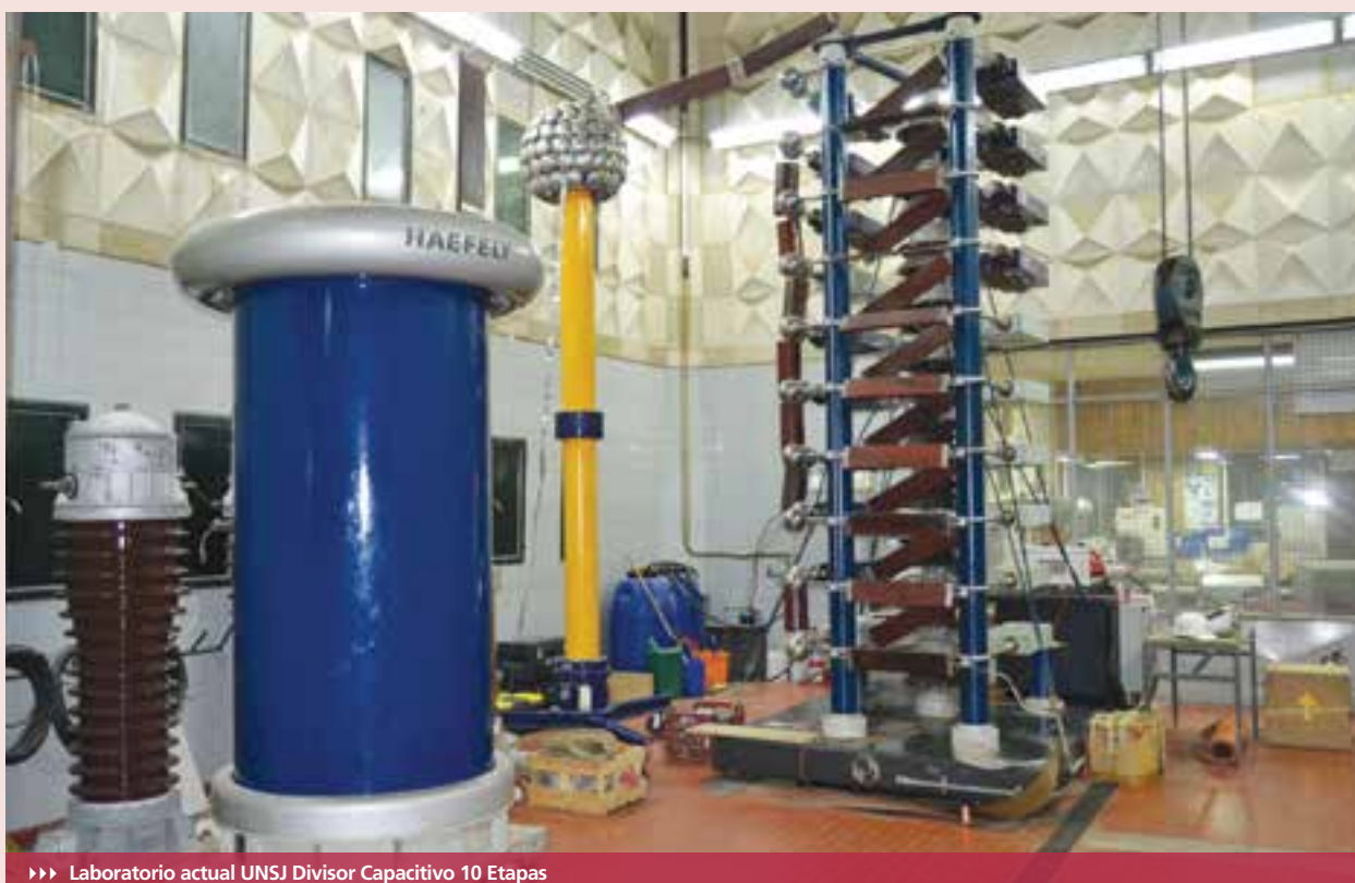
▶▶ Laboratorio actual UNSJ Divisor Capacitivo 10 Etapas
