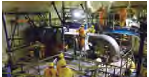
»» CENTRAL NUCLEAR EMBALSE / REACTOR: TUBOS DE PRESIÓN
